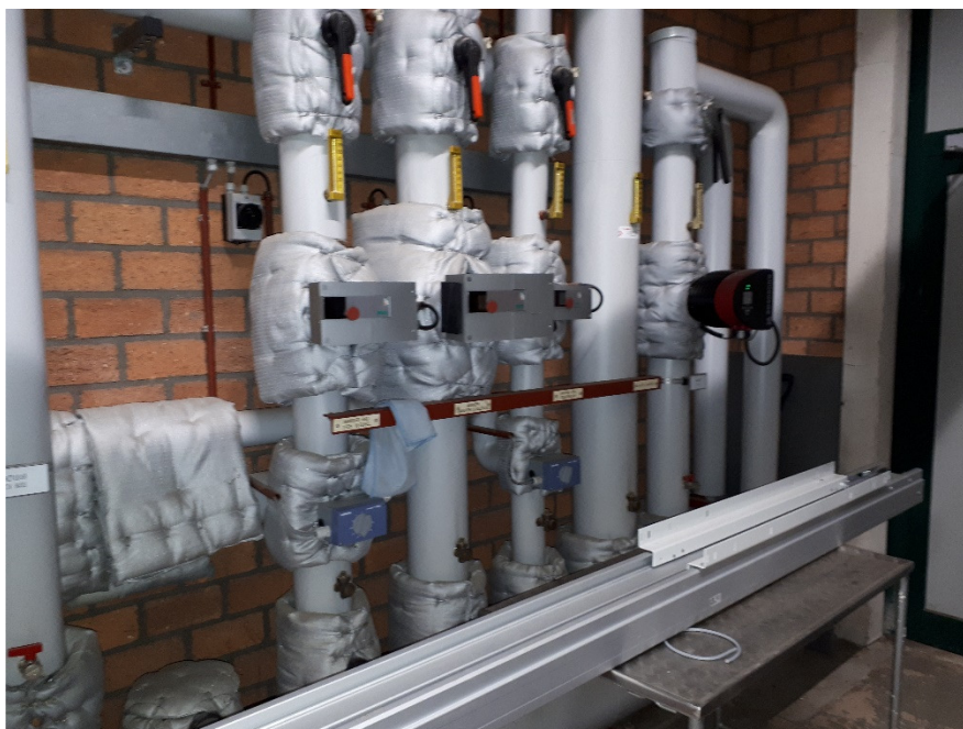
Afbeelding 7 Groepenverdeler in technische ruimte
