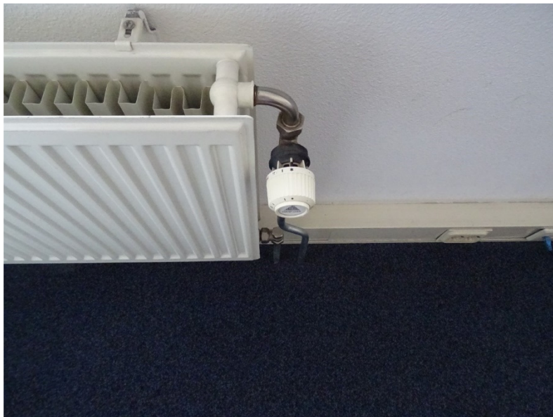
Afbeelding 6 Verwarmingselementen in de ruimte
