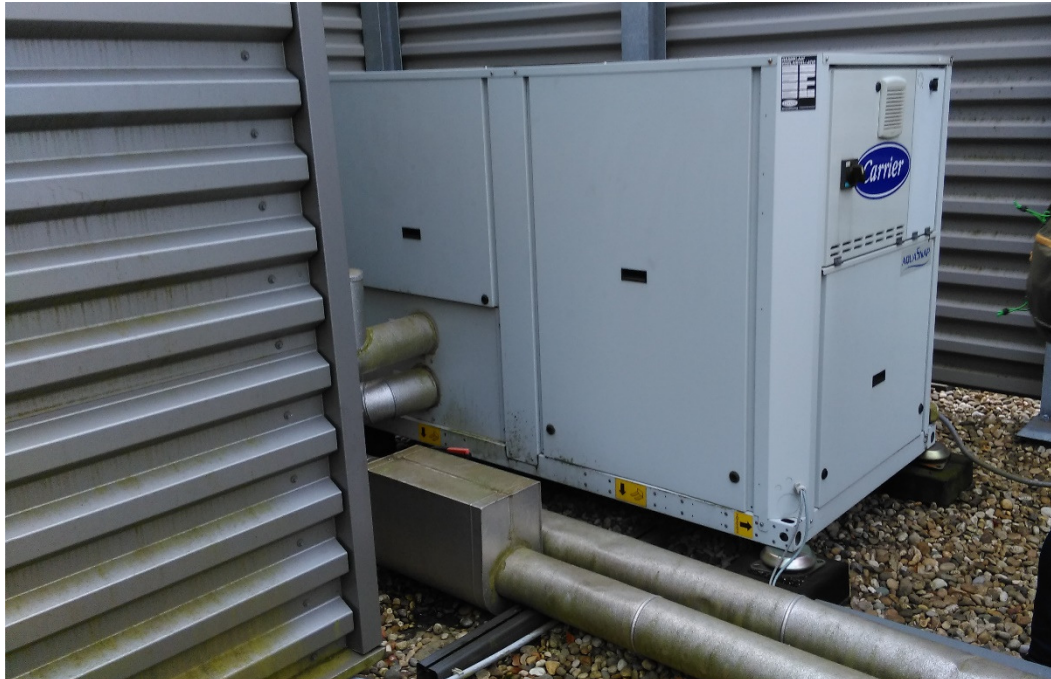
Afbeelding 13 Koelmachine op dak
