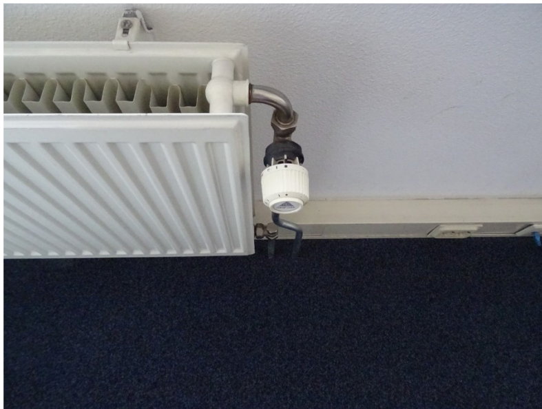
Afbeelding 6 Verwarmingselementen in de ruimte
