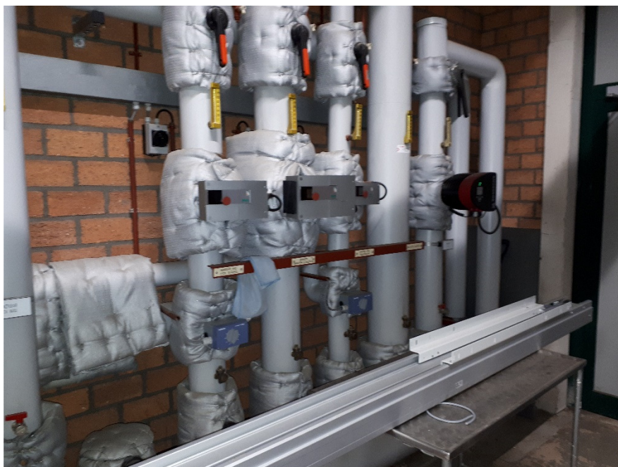
Afbeelding 7 Groepenverdeler in technische ruimte
