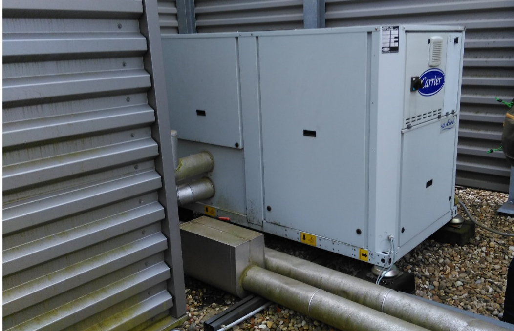
Afbeelding 13 Koelmachine op dak
