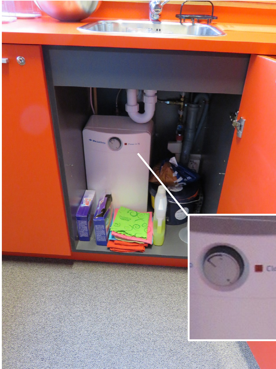
Afbeelding 12 Warmtapwater toestel in pantry
