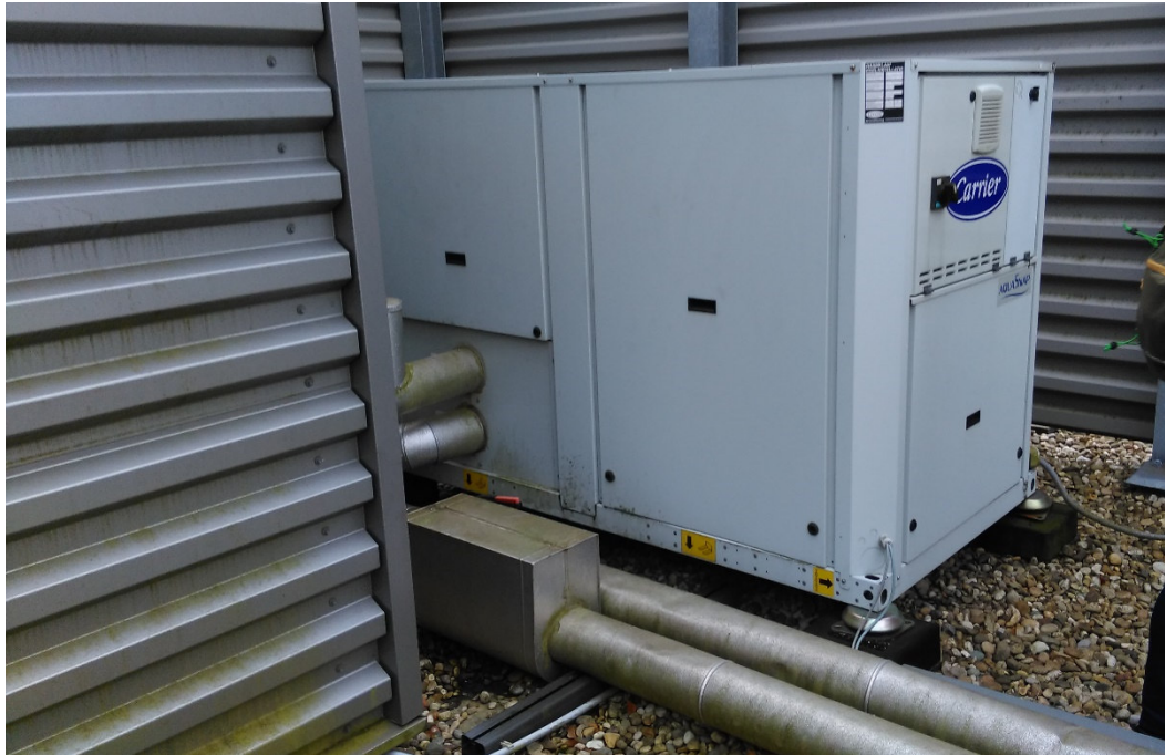
Afbeelding 10 Koelmachine op dak
