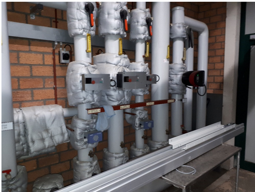
Afbeelding 6 Groepenverdeler in technische ruimte
