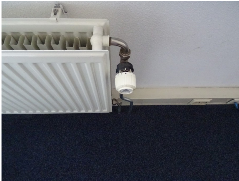
Afbeelding 5 Verwarmingselementen in de ruimte
